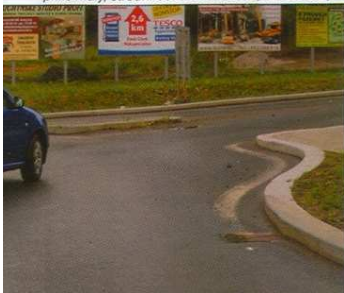
Foto č. 1 - nová okružní křižovatka - v protisměrných obloucích vznikají místa, kudy nikdo nejezdí a kde se hromadí nečistoty, v zimě pak sněh a led. Výjezdový poloměr na této křižovatce je příliš malý, střední ostrůvek rovněž (viz foto č.2)
