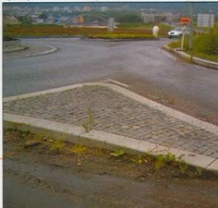
Foto č. 2 - hrana podél středního ostrůvku je vodorovná, u obrub se hromadí bláto a nedlouho po provozování zde již roste tráva.
