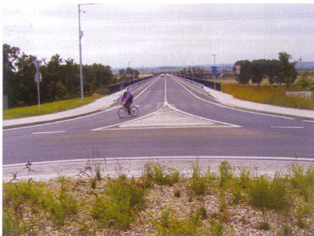
Obr. 1 Nevhodně tvarovaný dělicí ostrůvek, náhlá změna parametrů trasy
