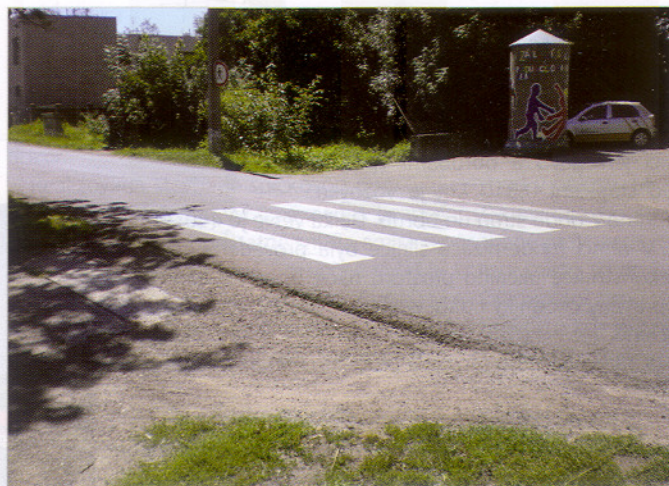
Obrázek 3: Absence vhodných nástupních ploch přechodu, absence hmatových úprav pro osoby slabozraké
