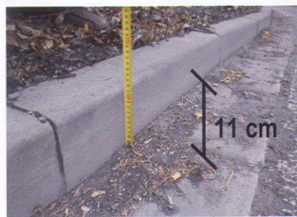
Obr. 4: Nízká podsádka osazení silniční betonové obruby
