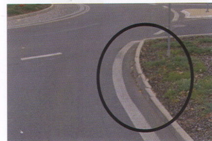
Obr. 9: Chrudim I/17 – Vyvrácené obruby nevhodného typu
