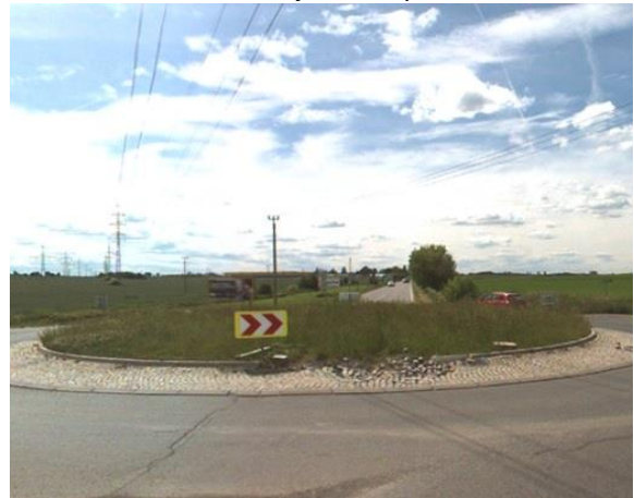
Obr. 8: Detail poškození středového ostrova vlivem nárazu
