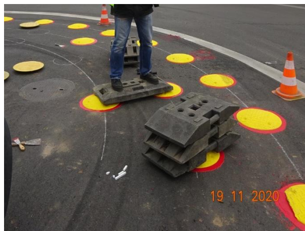
Obr. 7 – Stopa lepidla po projetí kamionu. Uštipnutá hrana byla doplněna pomocí lepidla.
